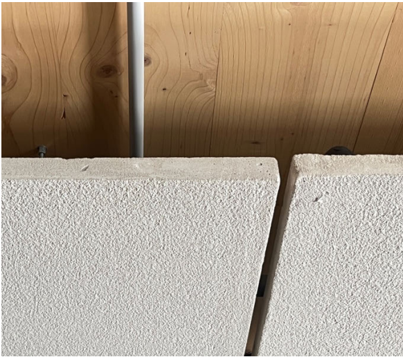
14: Unregelmäßigkeiten und Luftporen an Kanten und Ecke
